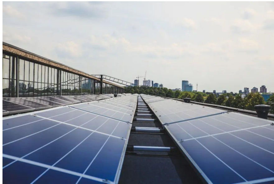
图 10：美的威灵园区屋顶光伏发电系统
